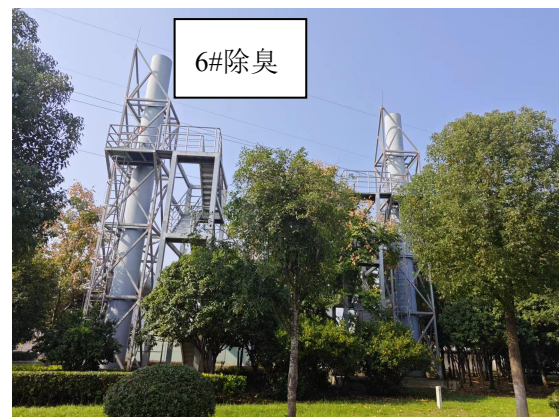
6#生物除臭装置排气筒
