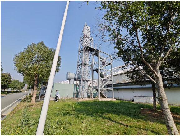
2#生物除臭装置排气筒
