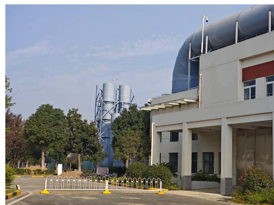
8#、9#生物除臭+化学除臭装置排气筒
