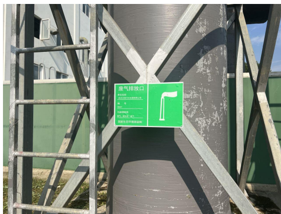
7#生物除臭装置排气筒
