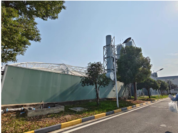
3#生物除臭装置排气筒
