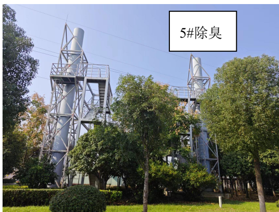
5#生物除臭装置排气筒
