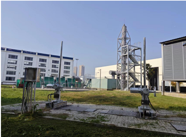
1#生物除臭装置排气筒
