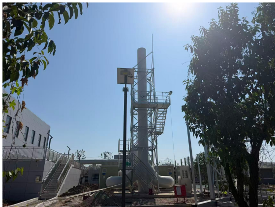
除臭系统排气筒
